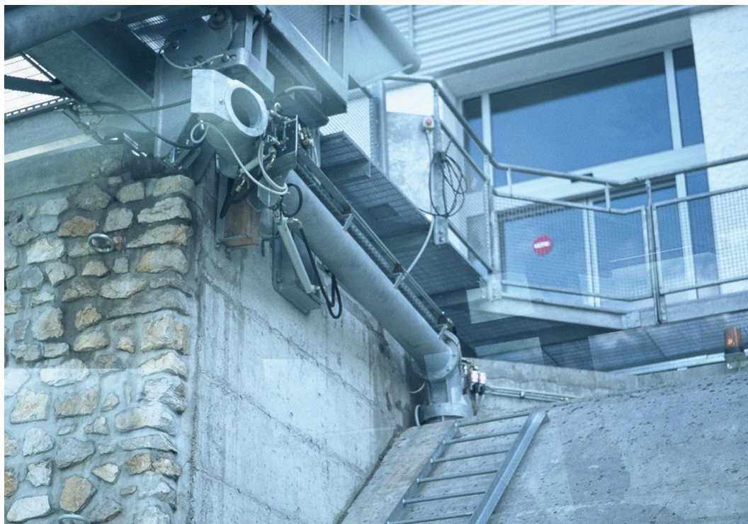
Slika 4.18: Sistem za iztok vode iz poliesterskega rezervoarja na zgornji postaji
